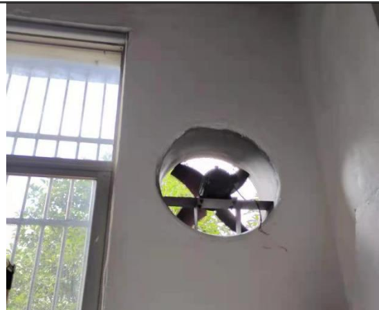
探伤室南墙机械排风装置
